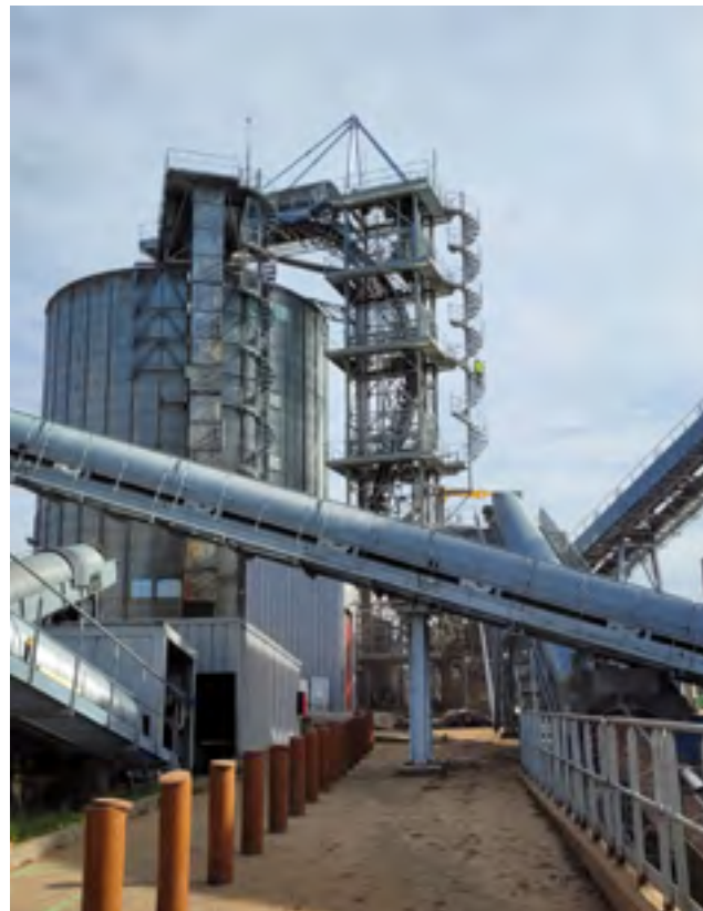
Chaufferie des Bellevues
