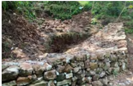
Protection d'un point d'eau à Haïti
