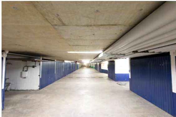
Plancher bas isolé par des panneaux rigides
