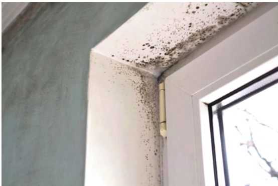
Développement de moisissures autour d'un pont thermique.
